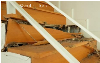
Escalier fortement fragilisé par des termites
